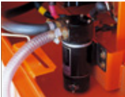
Bomba eléctrica de suministro de combustible.
